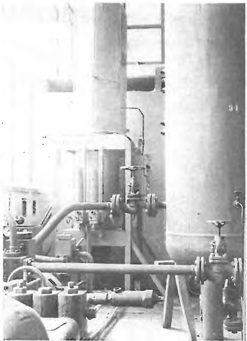
Naprave za kemično mehčanje vode v kotlovnici Tovarne pohištva Cerknica
