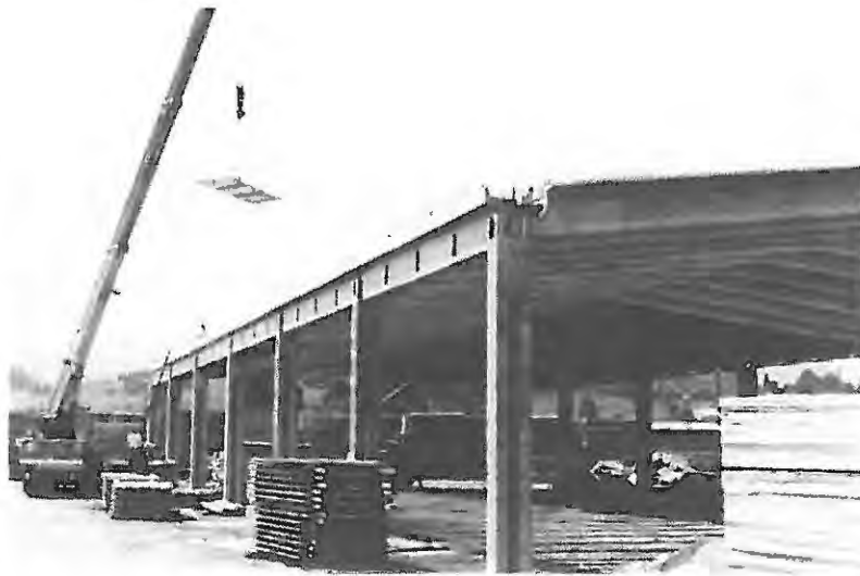
Za silvestrovo je ujma razkrila skladišče žaganega lesa v TOZD Žagalnica. Zdaj ga obnavljajo.
